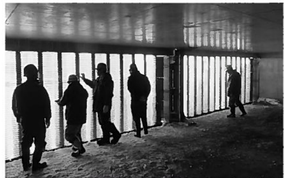
除塵機の中からの様子
