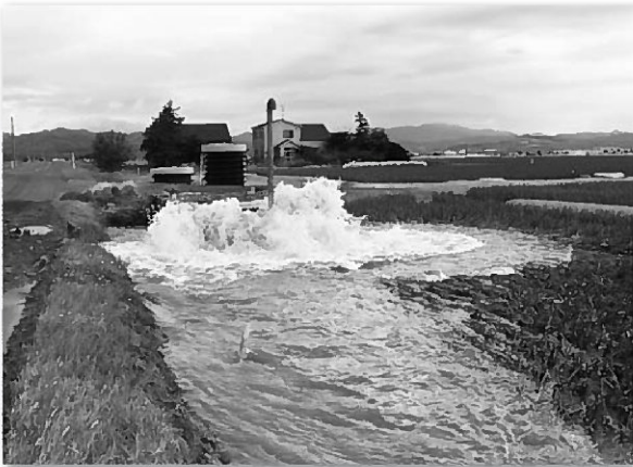
漏水事故現場
