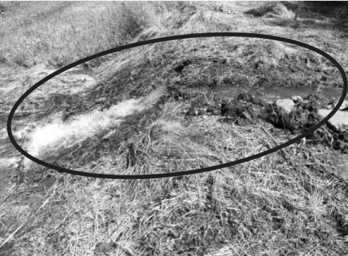
漏水箇所 全景
